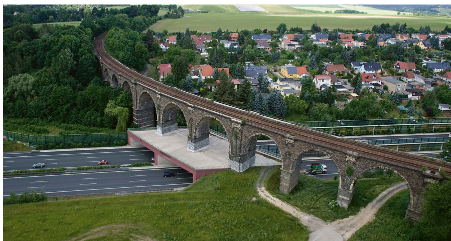
Bild 2. Bahrmühlenviadukt vor Beginn der Instandsetzung/Ertüchtigung 2006
