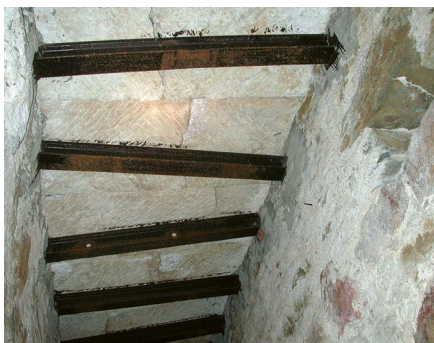
Bild 7. Unterstützung gebrochener Spandrillplatte aus Sandstein mit untergezogenen Schienen
